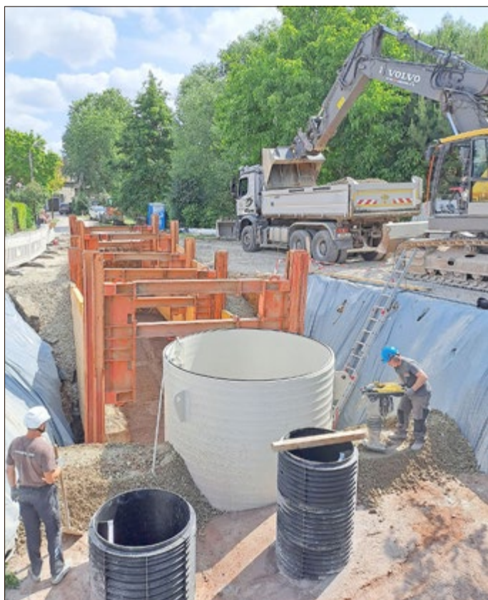
Beeindruckender Tiefbau: Der neu entstehende Stauraumkanal kann bis zu 220 Kubikmeter Wasser fassen und schützt bei Starkregenereignissen vor Überschwemmungen.
