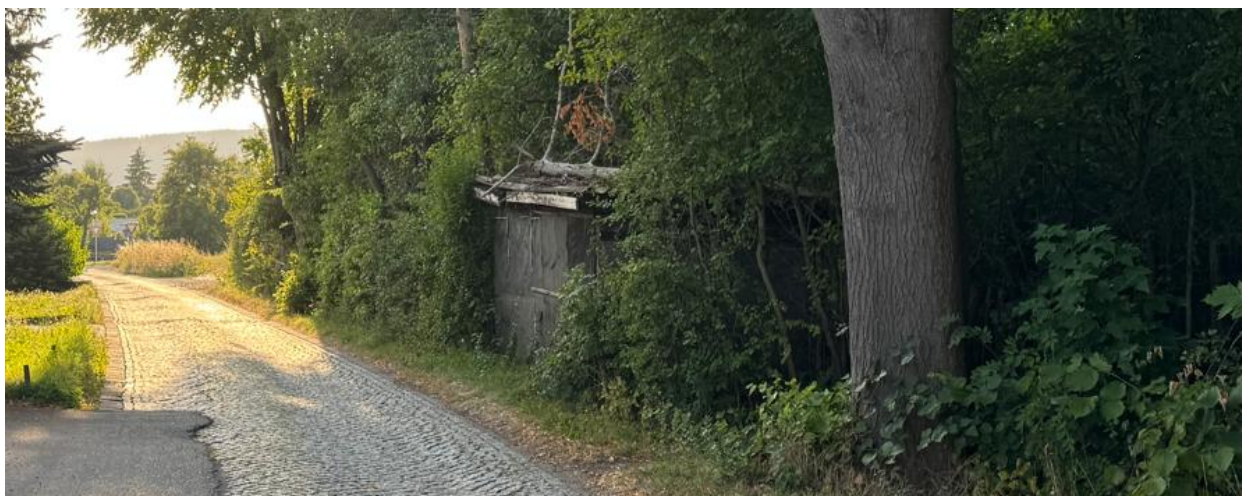
Ein Schuppen aus Restbeständen der vorhergegangenen Nutzungen. Derzeit ohne Nutzung und abbruchreif.
